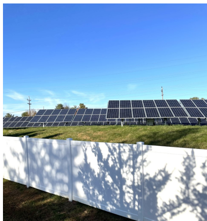
CSAAC's Solar Field
