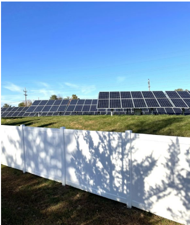
CSAAC's Solar Field
